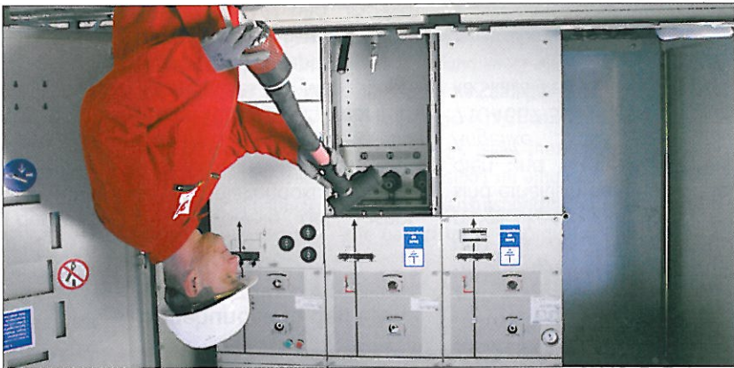
Die Umrüstung einer Ortsnetzstation ist innerhalb eines halben Werktages möglich. Aufgrund der Kalibrierung im Werk entfällt vor Ort die aufwändige Nachkalibrierung, die Messsensorik ist nach dem Prinzip »Plug & Play« direkt nutzbar.
